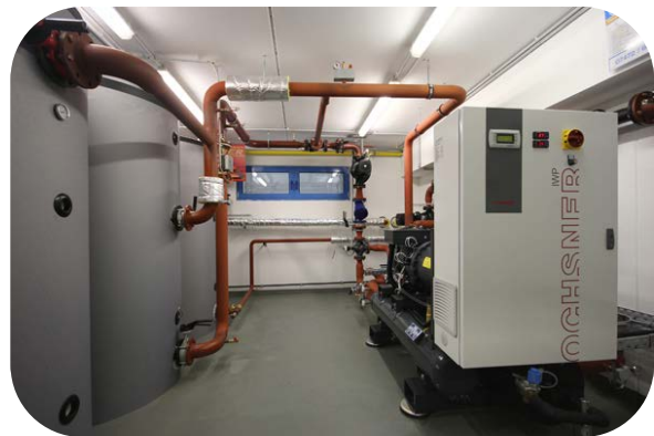
Foto: STADTwerke Amstetten
