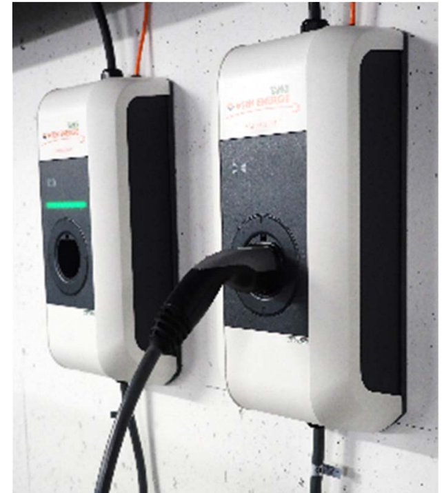
Foto: Wien Energie
