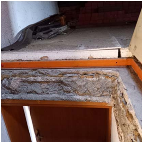
Abbildung 27: Detailaufnahme des Dämmzustands der obersten Geschoßdecke bei der Einzel-Vor-Ort-Beratung, die unmittelbar vor dem öffentlichen Teil der Beratung stattfand.
