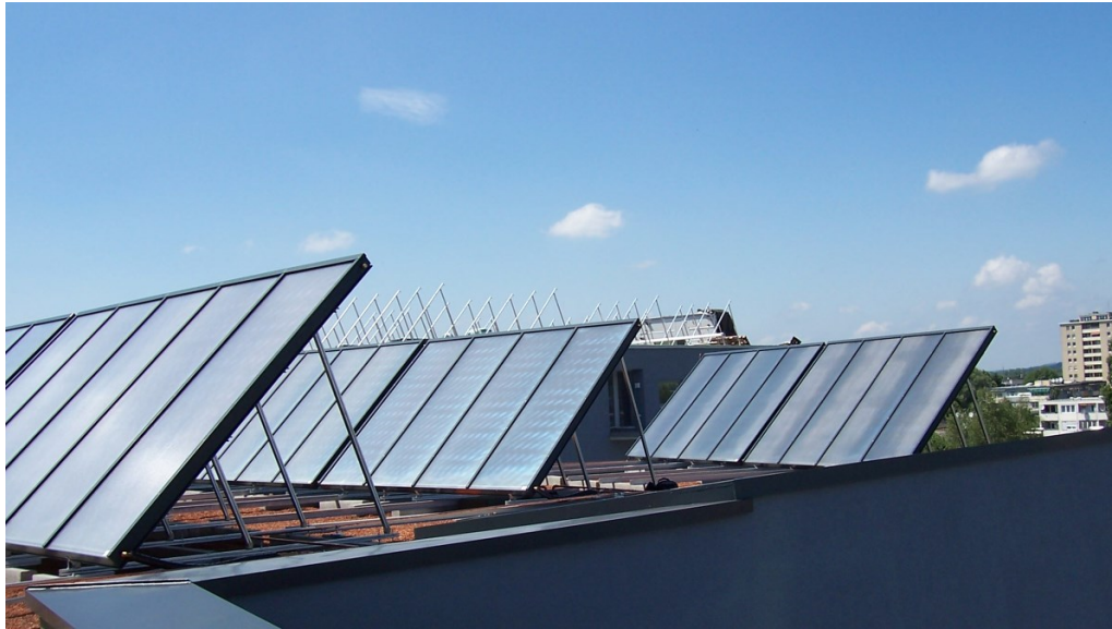
Solarkollektoren 45° aufgeständert auf Flachdach
