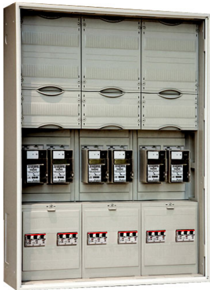
Abb. 17: Zählerkasten mit elektronischen Haushaltszähler
