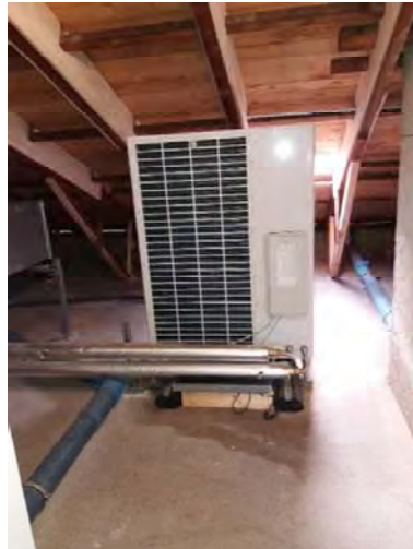
Abbildung 25: Luftwärmepumpe für die Wärmeversorgung der bereits zentral angeschlossenen Wohnungen
