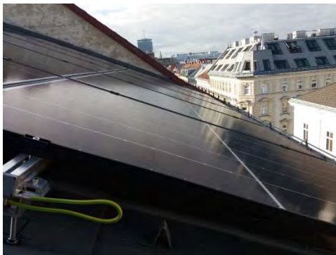
Abbildung 26: PV-Anlage am Dach der Liegenschaft Miesbachgasse 10
