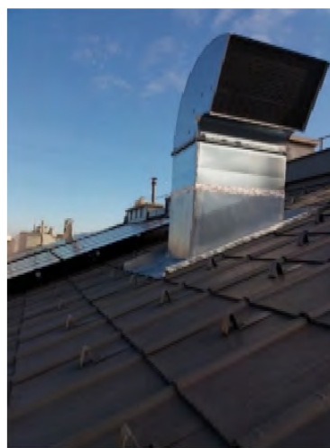
Abbildung 29: Öffnung in der Dachfläche, um den Luftaustausch für die Luftwärmepumpe zu gewährleisten, Außenansicht
