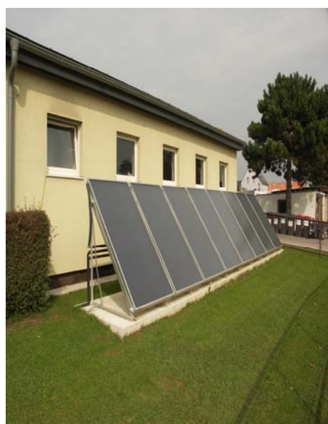
Thermische Solaranlage Sporthaus Stadion
