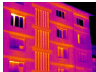
Vir: Energetski pregled večstanovskih stavb v občini Jesenice, izvajalec Gradbeni inštitut ZRMK, d.o.o., naročnik Občina Jesenice
