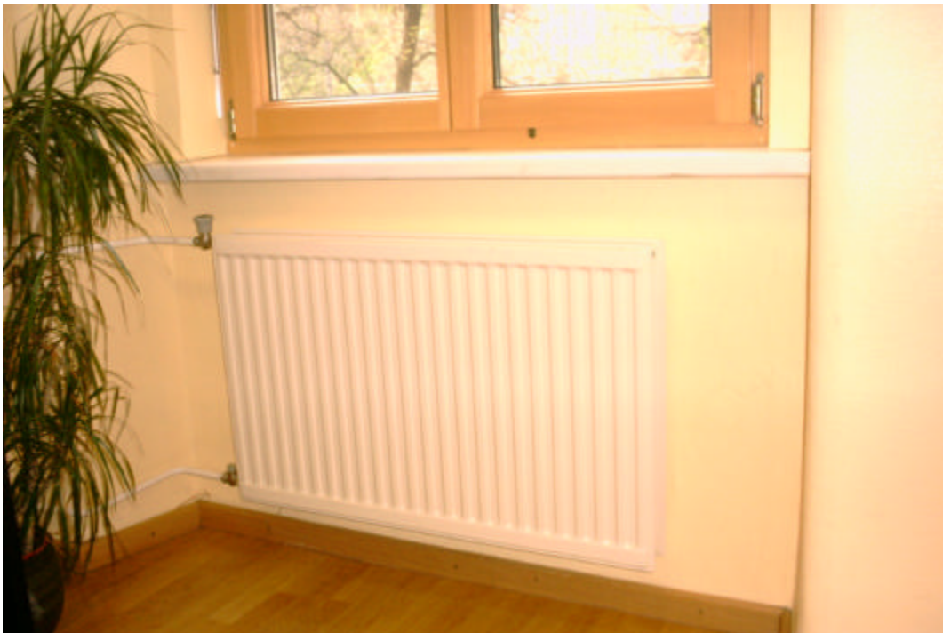
Heizkörper in Klassenraum
