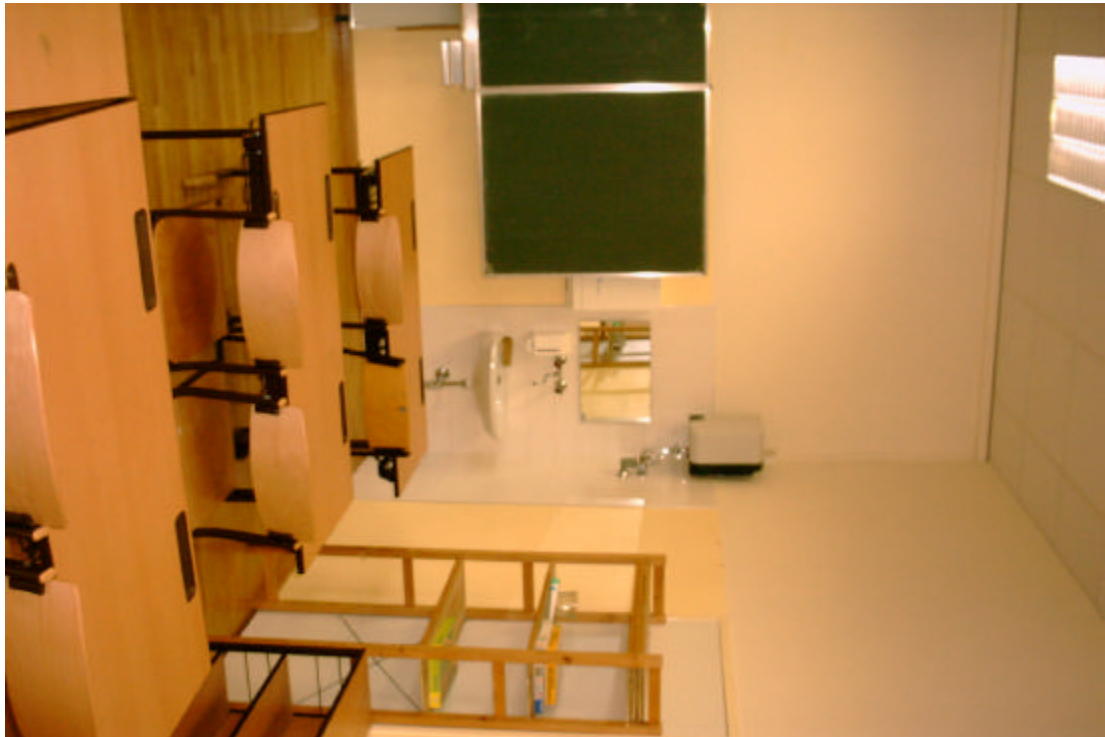
Klassenzimmer, ausgestattet mit Warmwasser-Elektrospeicher
